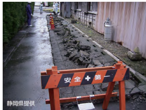
▲平成21年8月発災の駿河湾を震源とする地震で倒壊したブロック塀:静岡県提供
