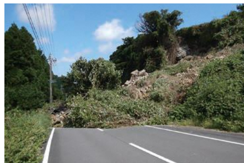
▲昨年9月の台風15号で発生した土砂崩れ
