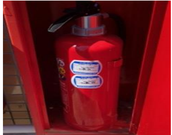
消火器点検確認(浄化センター)
