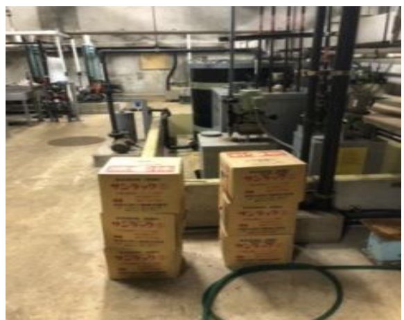
検査系排水処理施設確認(病院)
