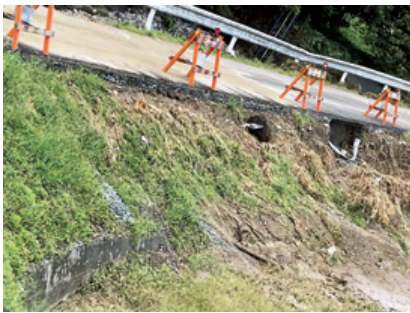
台風15号の被害箇所
