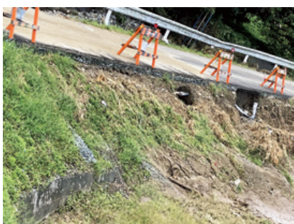
台風15号の被害箇所
