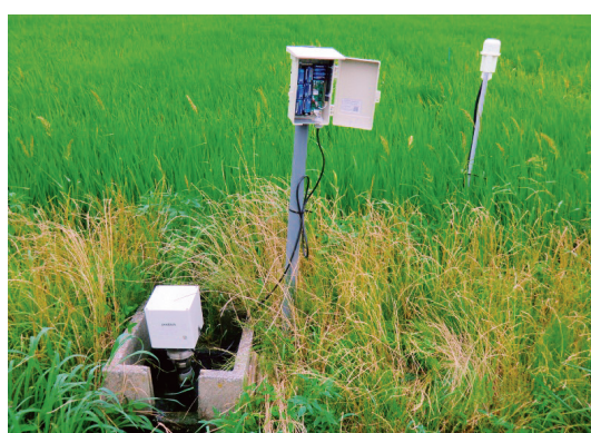
乾電池を電源としたパイプラインからの自動給水
