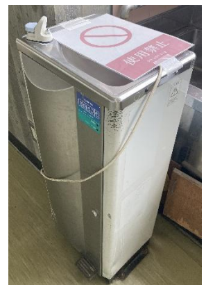
【故障中の冷水機】
