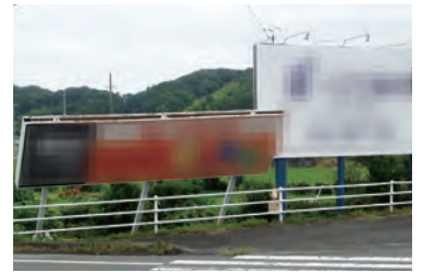
▲過去の台風で倒れた看板 普段から点検を行い、倒壊などによる被害を防止しましょう。
