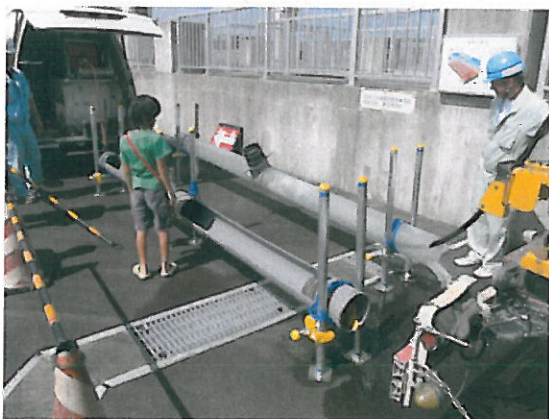
◎TVカメラ・高圧洗浄車 普段は見ることも出来ない、管路内の調査及び清掃を行う機械を間近で見、触ることができました。
