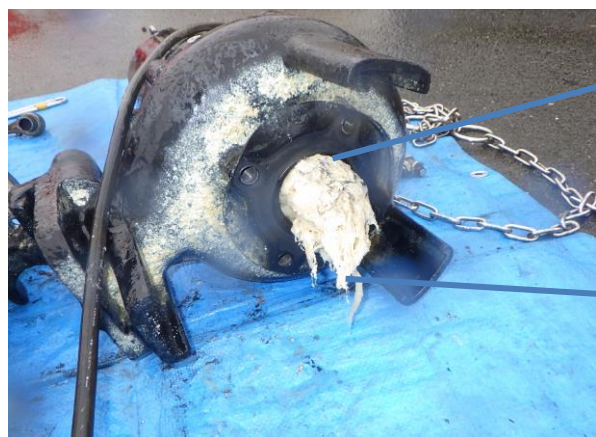
△異物が詰まった実際の現場写真△
